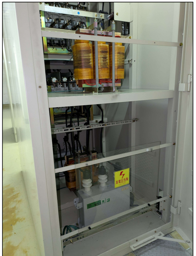
第4電気室 SC43-L43・SC44-
