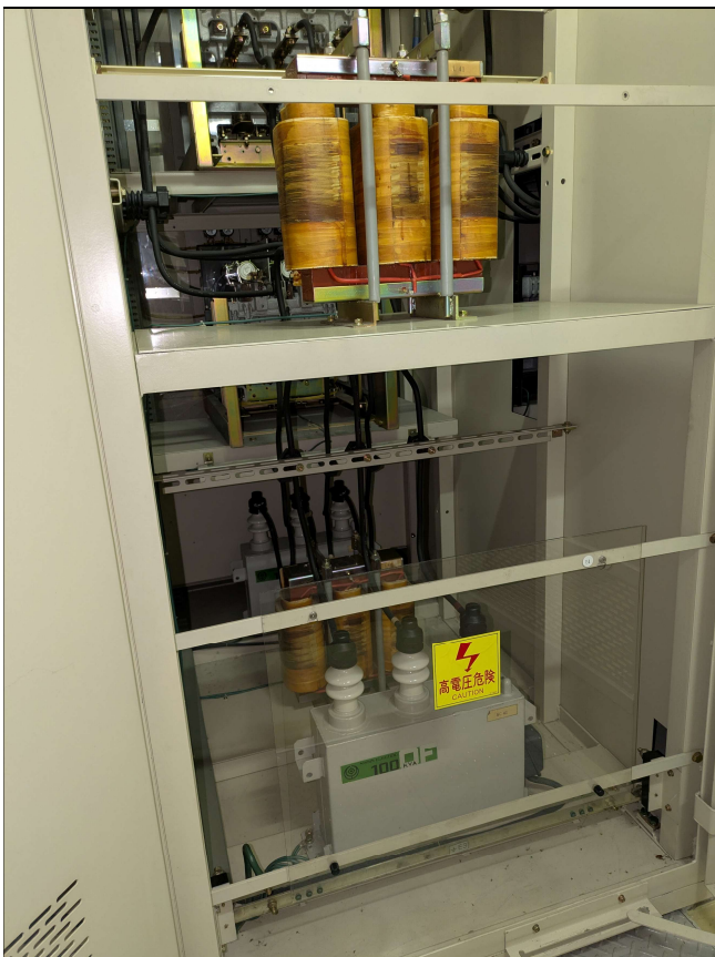
第4電気室 SC41-L41・SC42-
